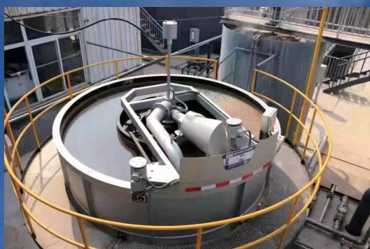
池州工厂新建污水处理系统
