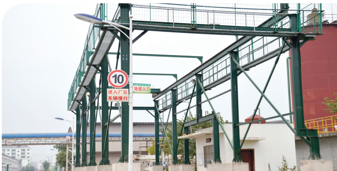
明阳厂已经投入使用的木片量方系统
